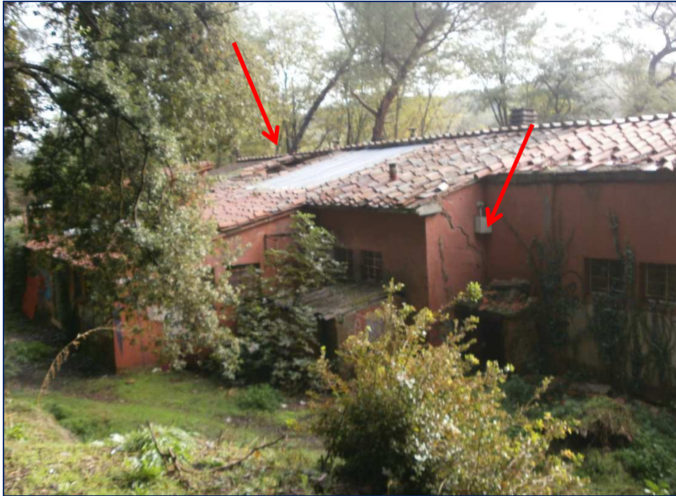
FOTO n. 3. Prospetto laterale delle Vecchie Terme. In evidenza: il crollo di una porzione del tetto e il cedimento strutturale di una testata angolare dell'edificio
