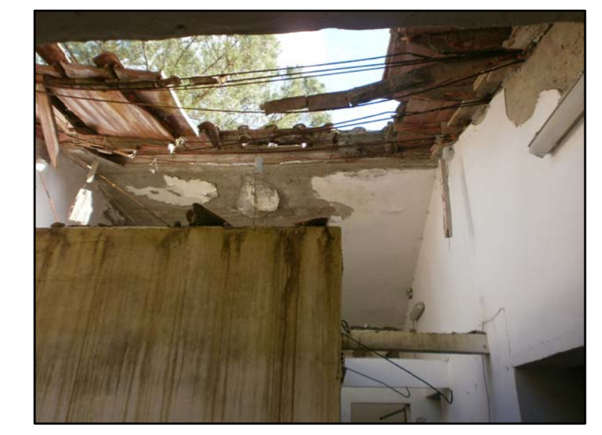
FOTO A. Interno: in evidenza il crollo del tetto
